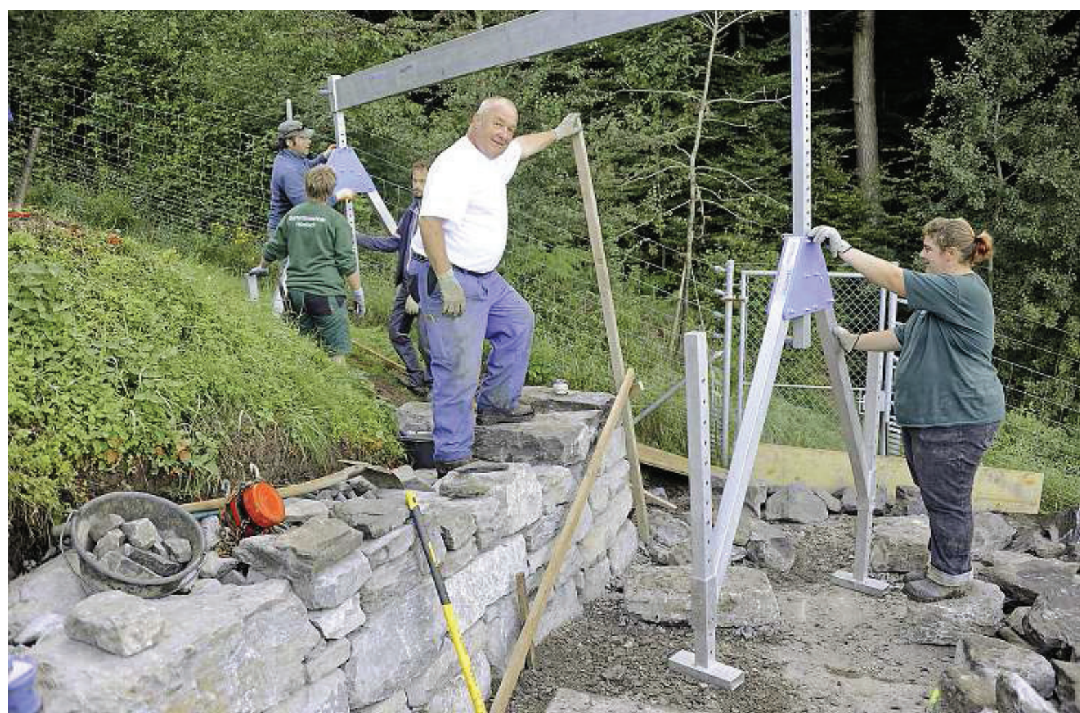
Gemeinsam wird ein Hebekran aufgestellt: Martin Stähli, Präsident der Rebbaugenossenschaft Hilterfingen (Mitte), freut sich über die guten Fortschritte beim Trockenmauerbau.
